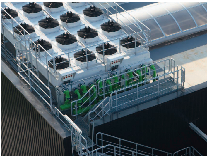
Kühlanlage für Biomasse-Verbrennungsanlage, Oostende (Belgien)
