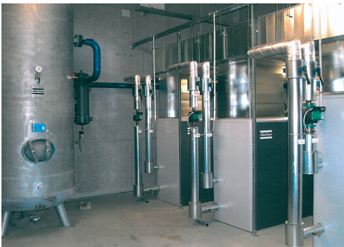
Wärmerückgewinnung an Kompressorenanlage für Automobilzulieferindustrie, Wustermark
